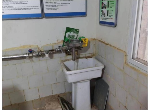
化学品存放区域配备应急洗眼设施
