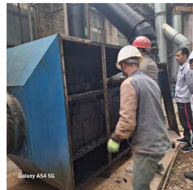
VOCs 废气处理设施更换活性炭
