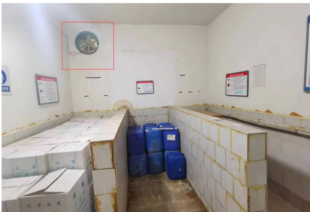
化学品存储区域通风设施
