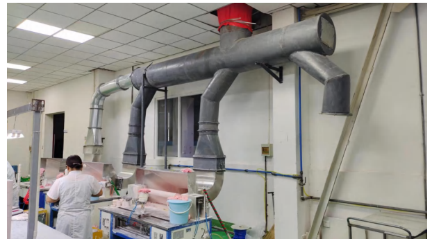
车间抽风设施
