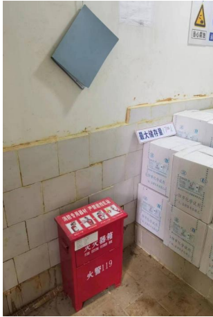
化学品存放区域配备消防应急设施
