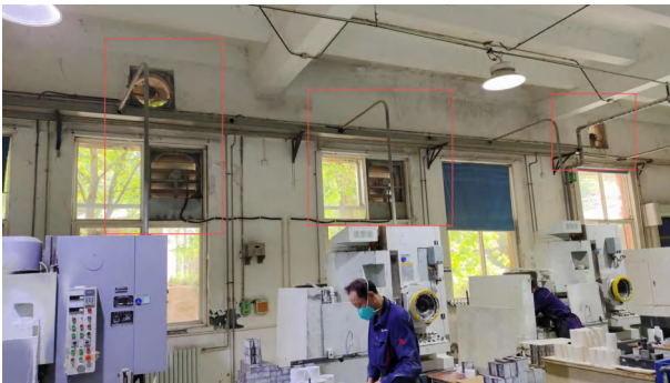
车间抽风设施
