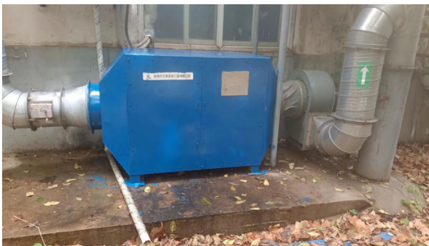
废气处理设施
